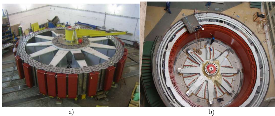
Slika 4.1.2 a) Rotor b) stator razmatranog generatora u HE „Bajina Bašta“
